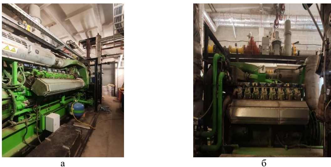
Рис. 3. Когенераційна установка: а – вид збоку; б – вид прямо
