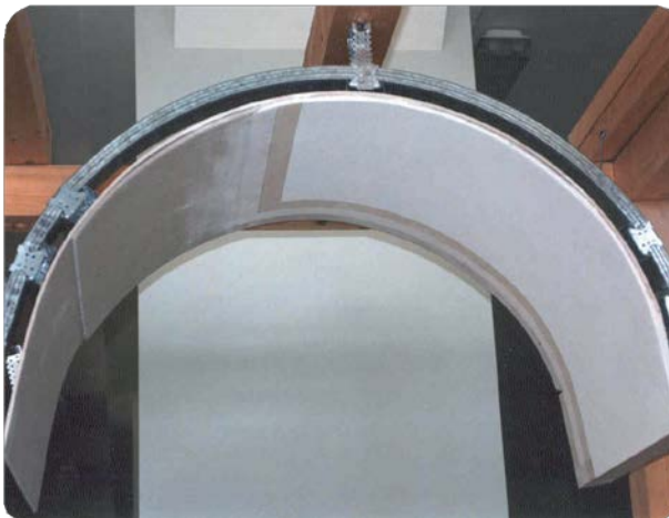
Мал. 6.4. Навчальний стенд з фрагментом улаштування арки напівкруглої форми з двошаровою гіпсокартонною обшивкою
