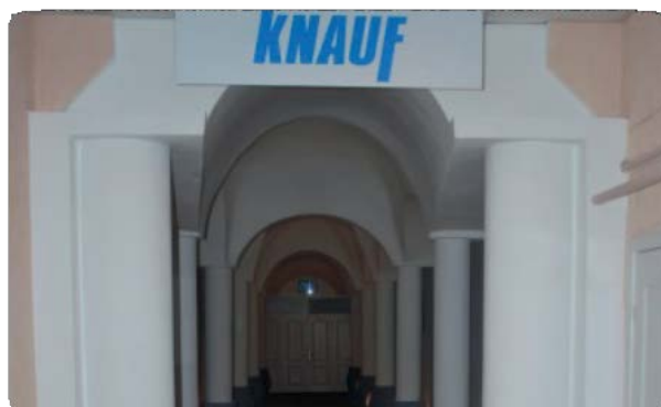
Мал. 6.34. Б. Дизайн підвісної стелі коридору з гіпсокартонними елементами великого радіуса. ДВПУБ. 2012 р.
