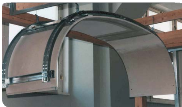
Мал. 6.6. Навчальний стенд з фрагментом улаштування арки коробчастої трицентрової форми з двошаровою гіпсокартонною обшивкою
