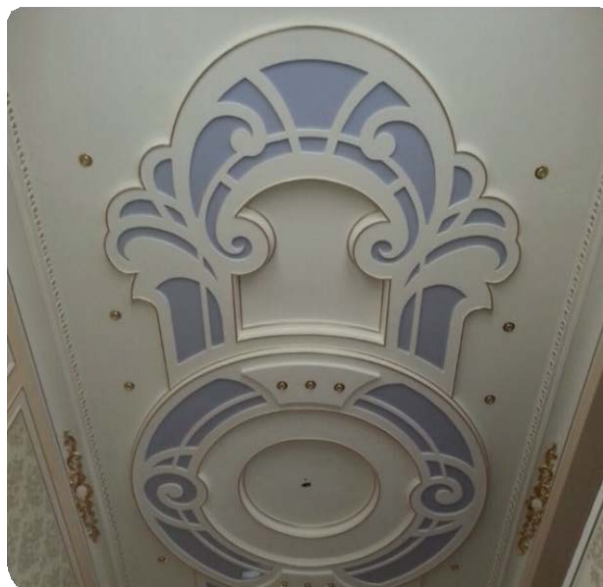
Мал. 3.50. Фрагмент прямолінійної підвісної стелі з гіпсокартону з декоративним опорядженням накладними гіпсокартонними елементами
